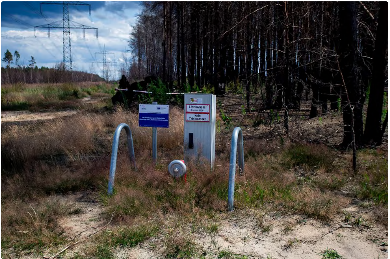
Eine der Brunnen in Beelitz. Hier zu sehen ist ein Löschbrunnen, der zum Waldbrandschutz vorgesehen ist.
