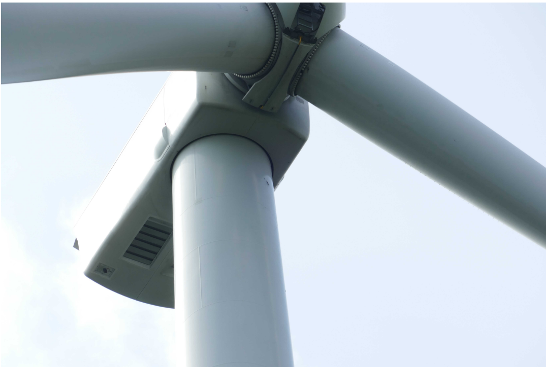
Abbildung 15: Maschinenhaus der Windkraftanlage GE-28130157 mit leichten Verschmutzungen.
