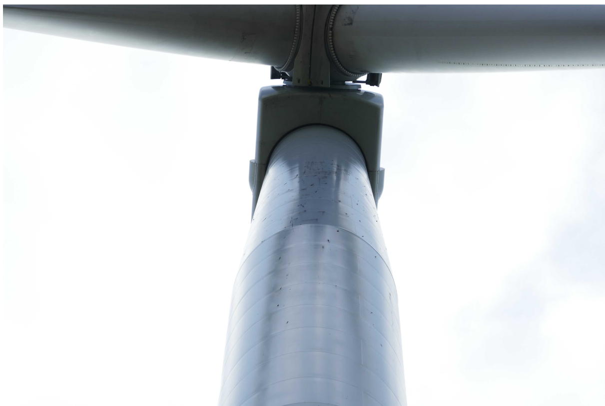
Abbildung 17: Maschinenhaus der Windkraftanlage GE-28130158 mit erkennbaren Verschmutzungen.
