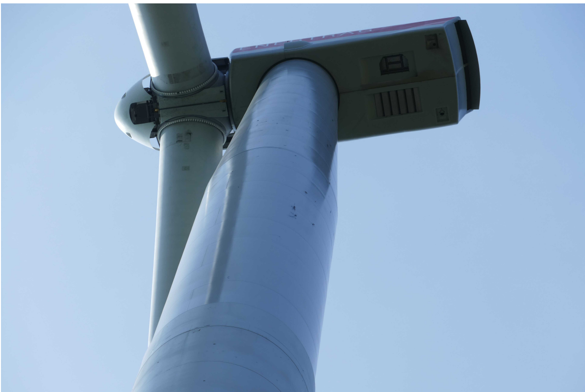
Abbildung 11: Maschinenhaus der Windkraftanlage GE-28130155 mit erkennbaren Verschmutzungen.
