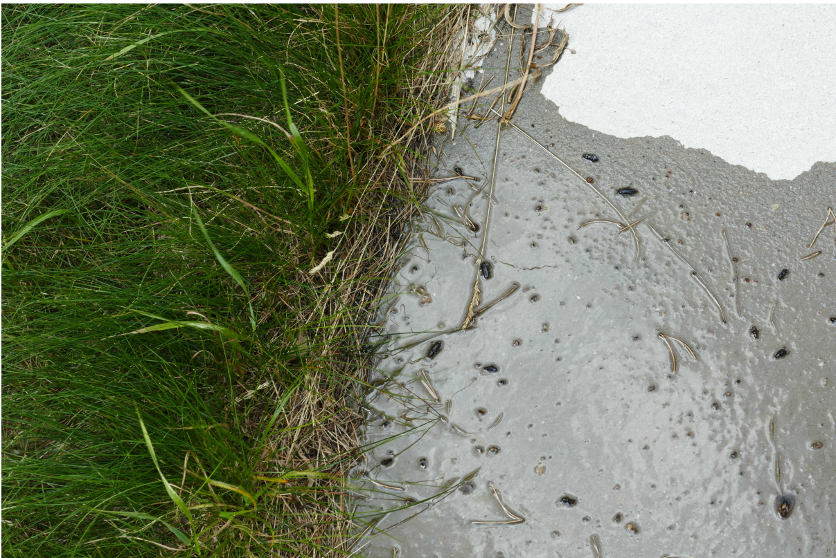
Abbildung 24: vom Sockel laufendes Öl von der Windkraftanlage GE-28150127.
