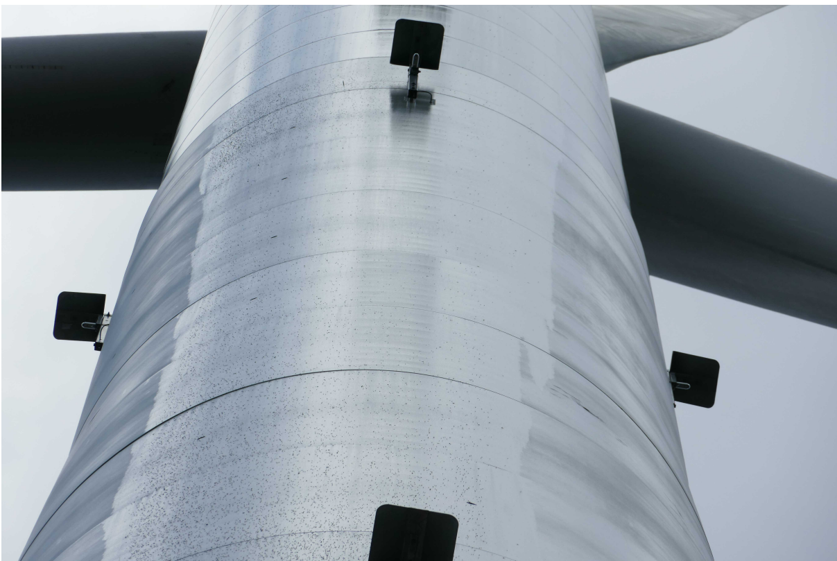
Abbildung 22: Erkennbare Ölspur an der der Windkraftanlage GE-28150127; die kleinen schwarzen Punkte sind Insekten.
