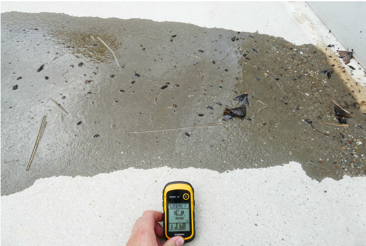
Abbildung 23: Öl am Sockel der Windkraftanlage GE-28150127 mit toten Insekten.
