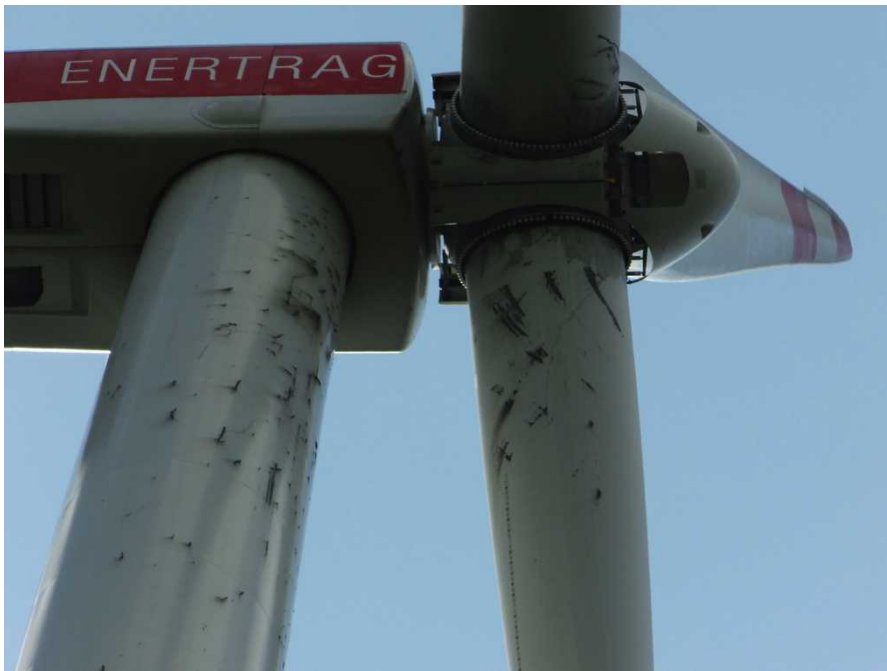
Abbildung 2: starke Verschmutzung der Rotoren und des Anlagenmastes der Windkraftanlage (GE-28130155) im Windfeld Rietz am 20.09.2017
