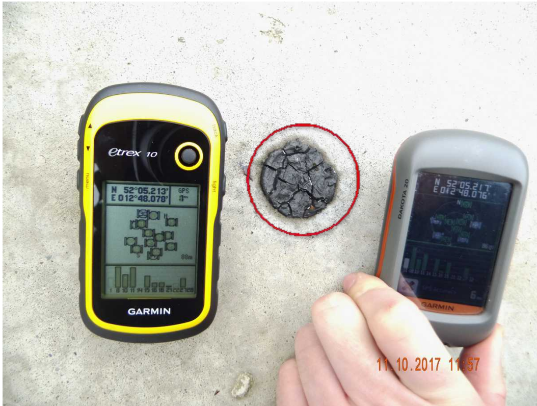
Abbildung 49: Schmierfettfund (rot markiert) an der Windkraftanlage GE-28130158; Aufnahme mit GPS-Koordinaten-Abgleich
