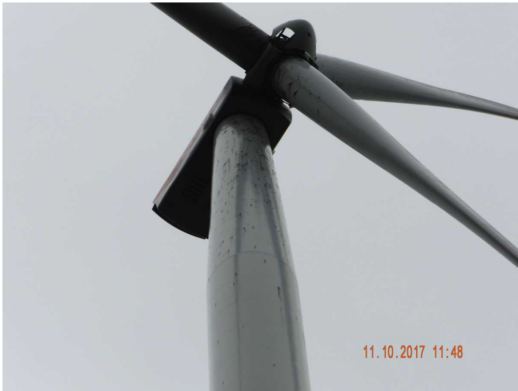
Abbildung 33: Maschinenhaus der Windkraftanlage GE-28130158 mit erkennbaren Verschmutzungen
