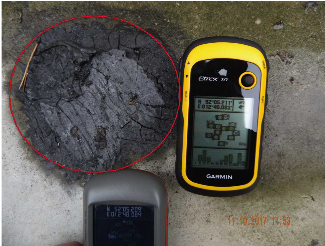
Abbildung 39: Schmierfettfund (rot markiert) an der Windkraftanlage GE-28130158; Aufnahme mit GPS-Koordinaten-Abgleich
