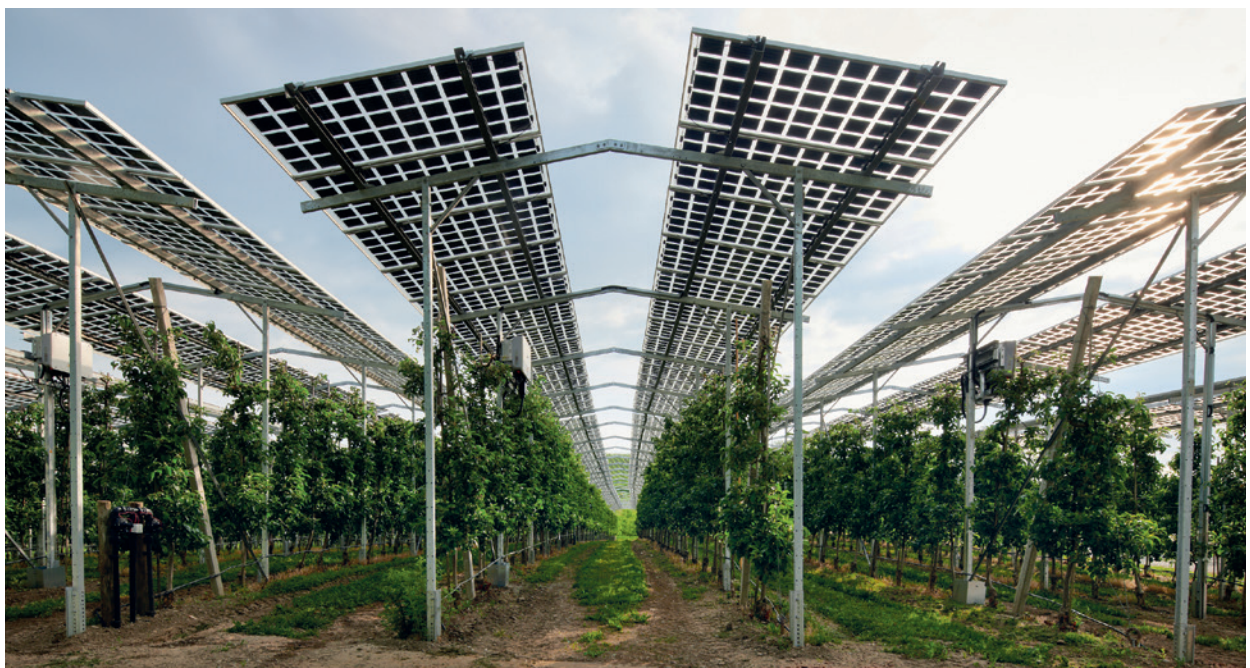
Foto: Fraunhofer ISE
